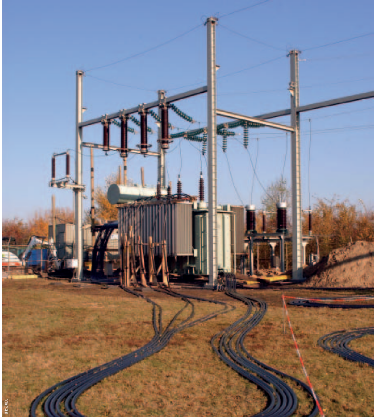
Werzaamheden aan een middenspanningsstation.
